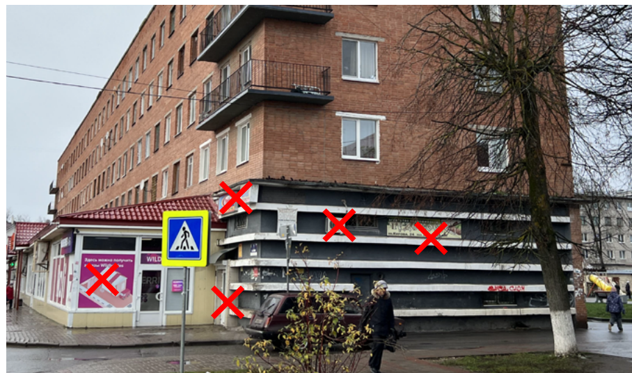
Баннеры на фасаде Сплошная заклейка окон Хаотично расположенное на фасаде оборудование Вывески в виде светового короба Фрагментарная отделка фасада
